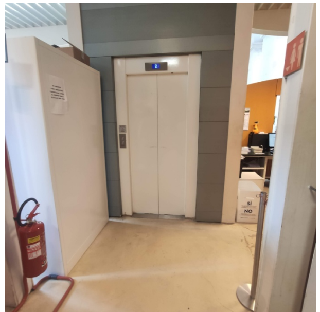
Foto 6.33 - vista ascensore (AS.B.02) collegamento biblioteca
